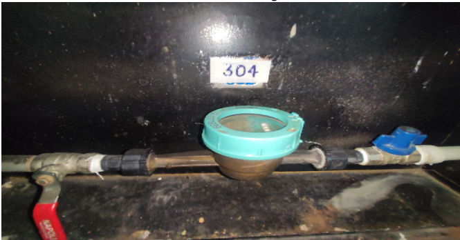
Contador de Agua
