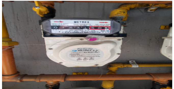
Contador de Gas
