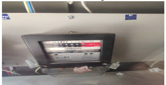
Contador de Energia
