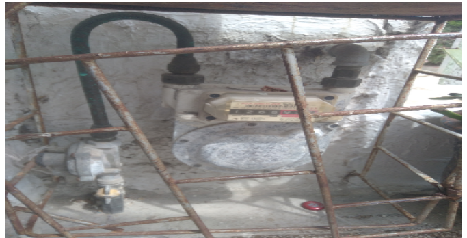
Contador de Gas
