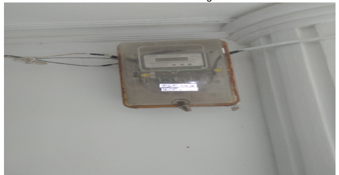
Contador de Energia
