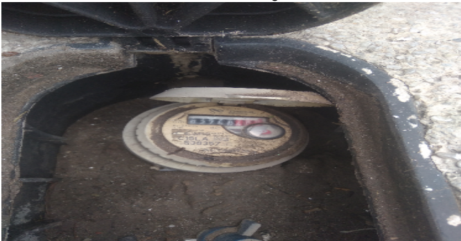
Contador de Agua
