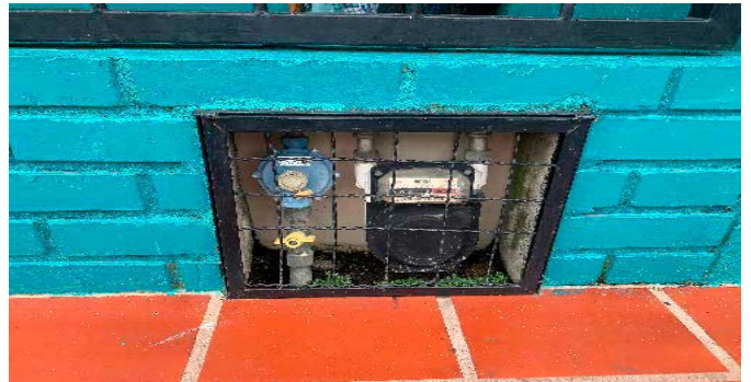
Contador de Gas
