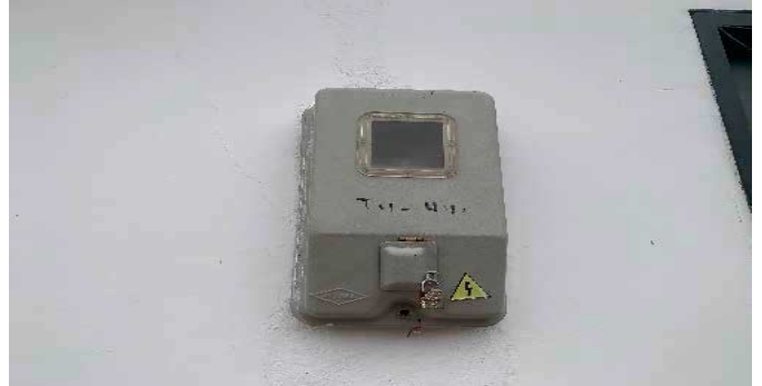
Contador de Energia
