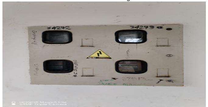
Contador de Energia
