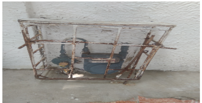
Contador de Gas
