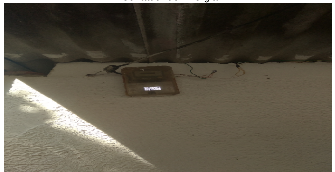
Contador de Energia
