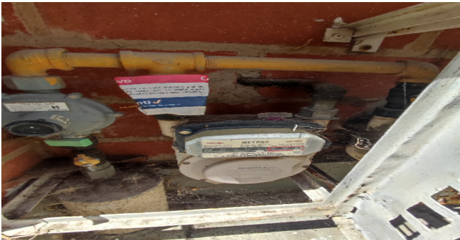
Contador de Gas
