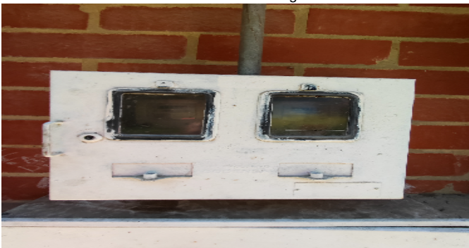
Contador de Energia
