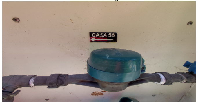
Contador de Agua
