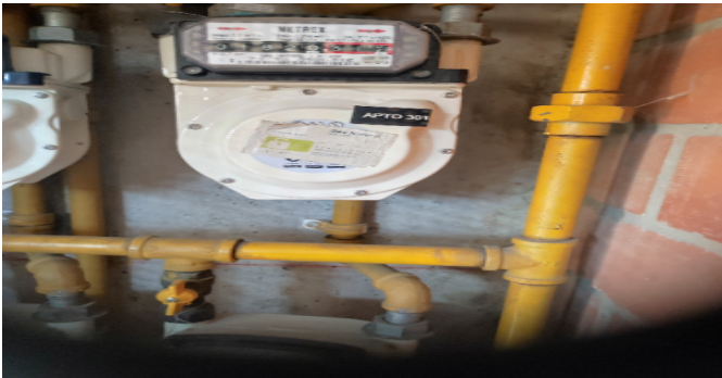
Contador de Gas
