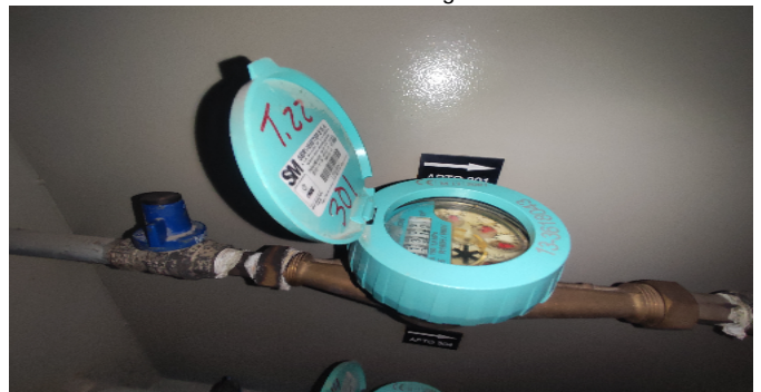
Contador de Agua
