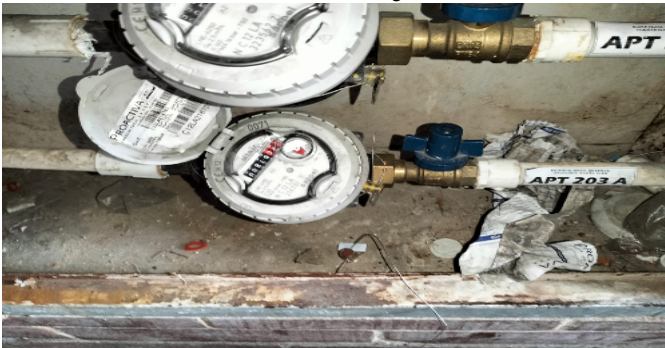
Contador de Agua
