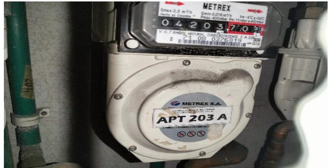
Contador de Gas
