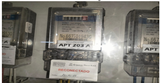
Contador de Energia
