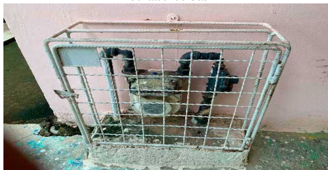
Contador de Gas
