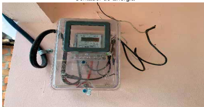
Contador de Energia
