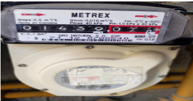
Contador de Gas
