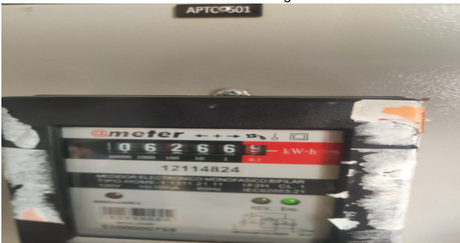
Contador de Energia
