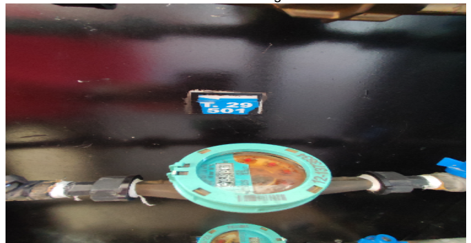
Contador de Agua
