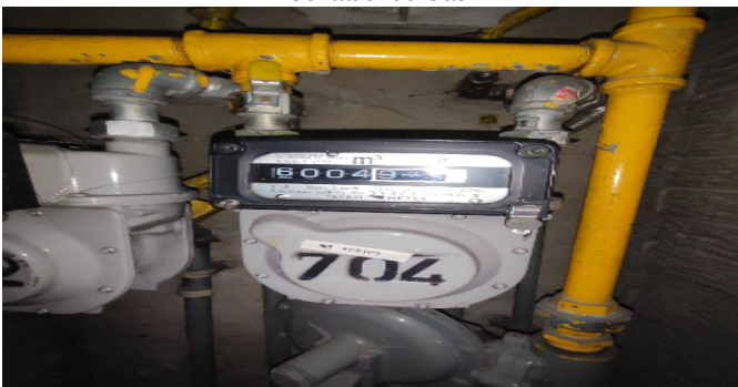
Contador de Gas
