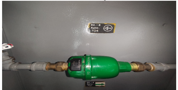
Contador de Agua
