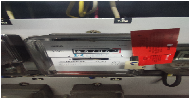
Contador de Energia
