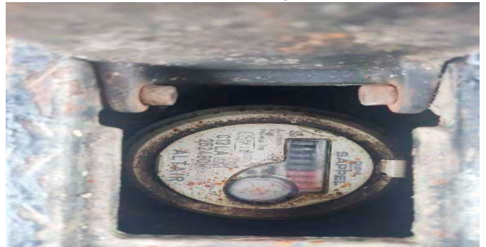
Contador de Agua
