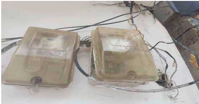
Contador de Energia
