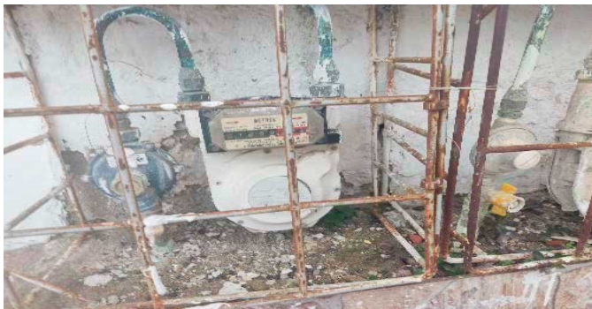
Contador de Gas
