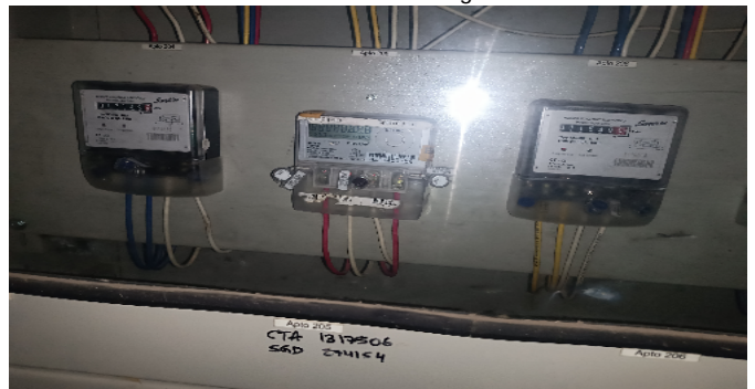
Contador de Energia
