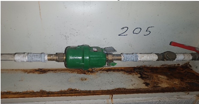
Contador de Agua
