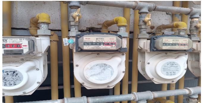
Contador de Gas
