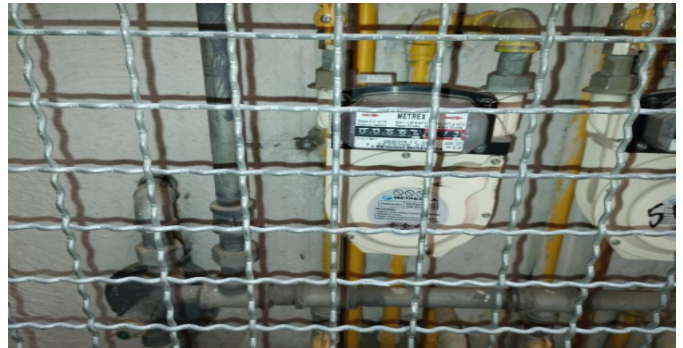
Contador de Gas
