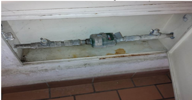
Contador de Agua
