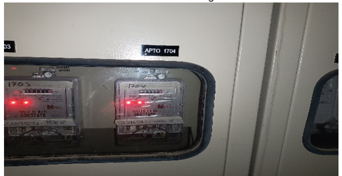
Contador de Energia
