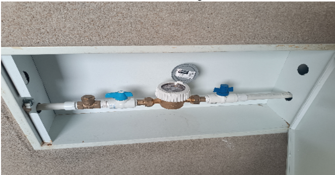
Contador de Agua
