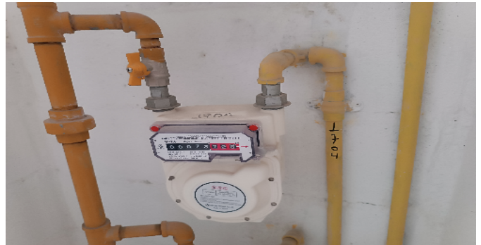
Contador de Gas
