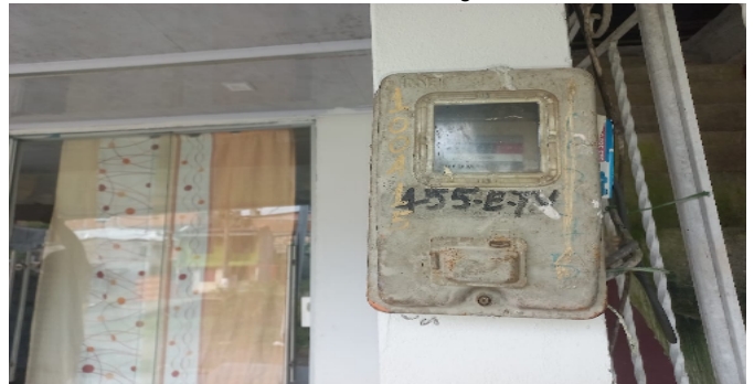
Contador de Energia
