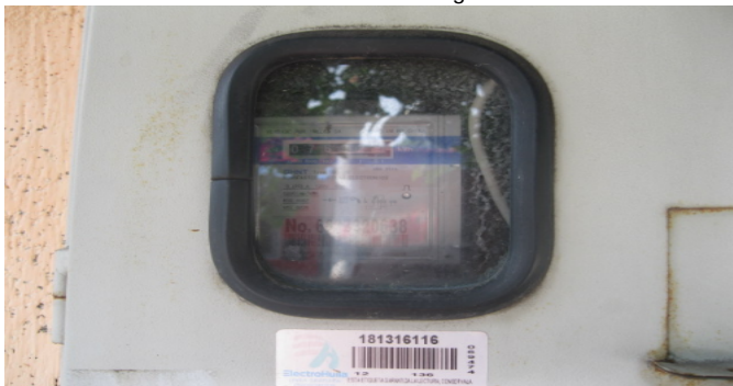
Contador de Energia
