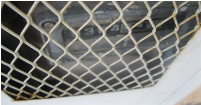
Contador de Gas
