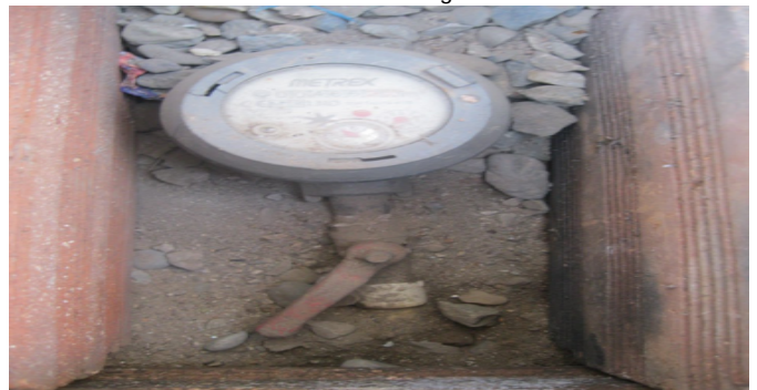
Contador de Agua
