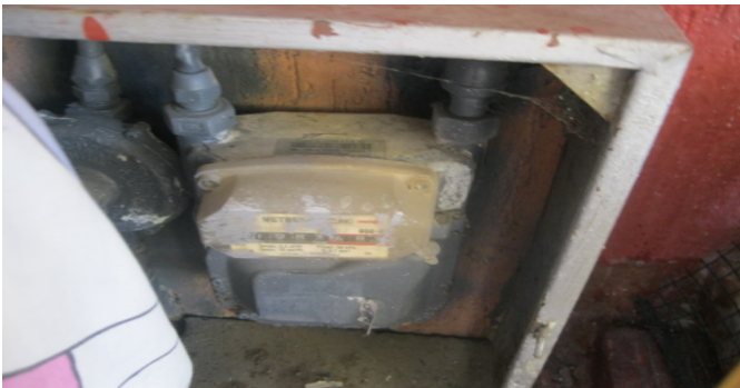
Contador de Gas
