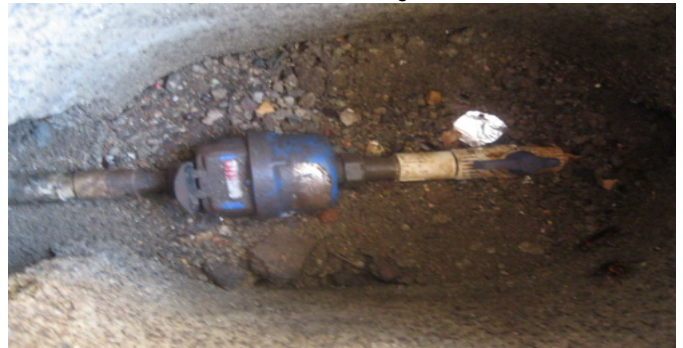
Contador de Agua
