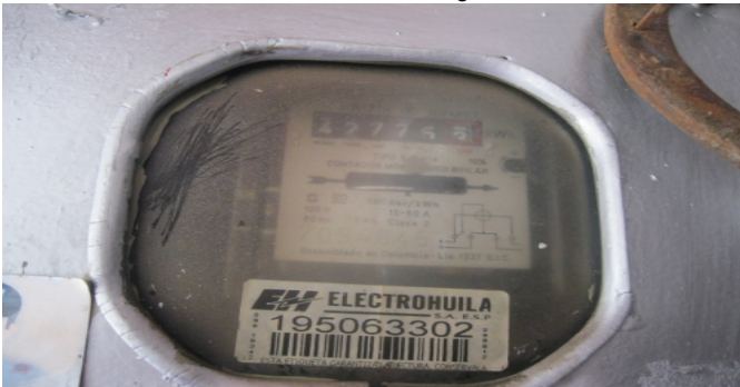
Contador de Energia
