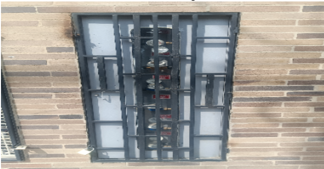
Contador de Agua
