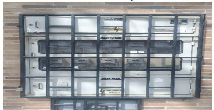
Contador de Energia
