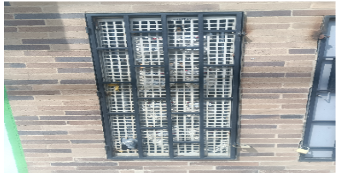
Contador de Gas
