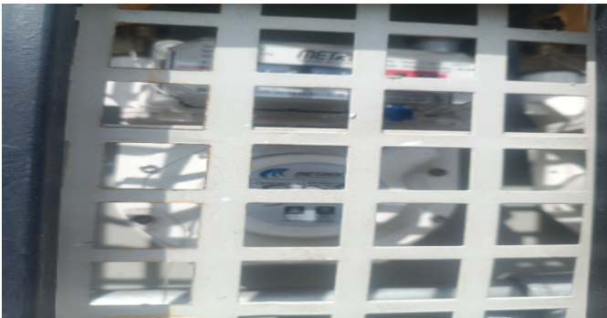
Contador de Gas
