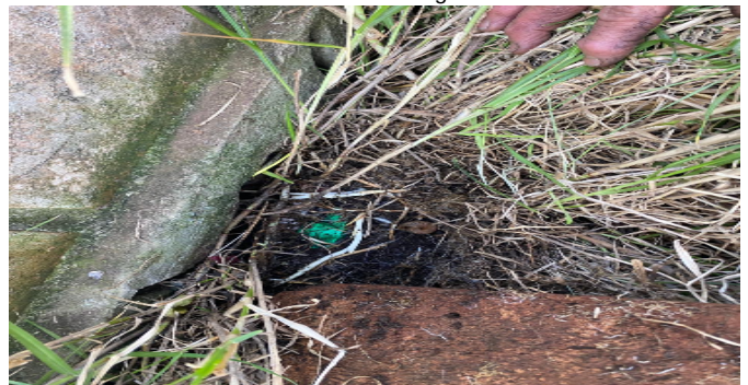
Contador de Agua
