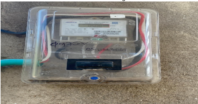
Contador de Energia
