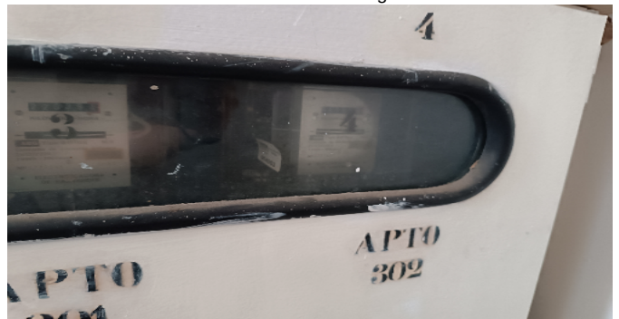
Contador de Energia
