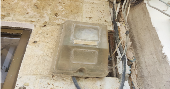
Contador de Energia
