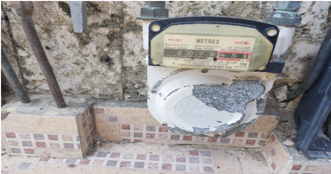
Contador de Gas
