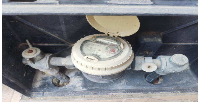
Contador de Agua
