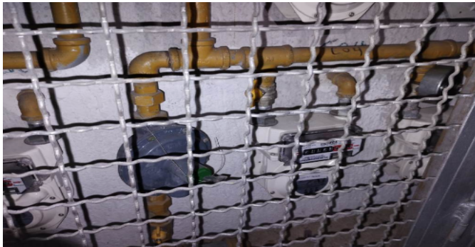
Contador de Gas
