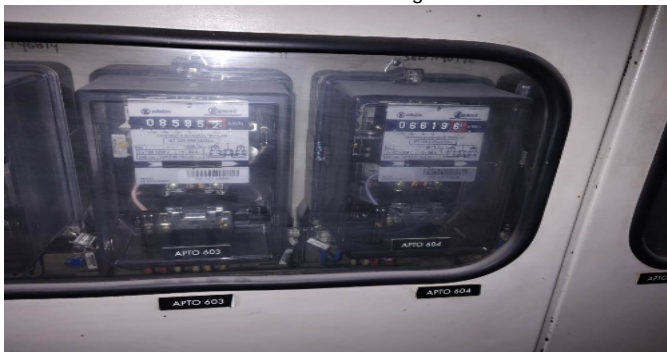
Contador de Energia
