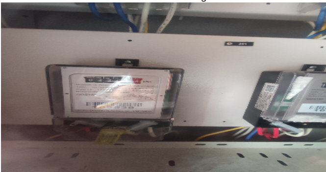
Contador de Energia
