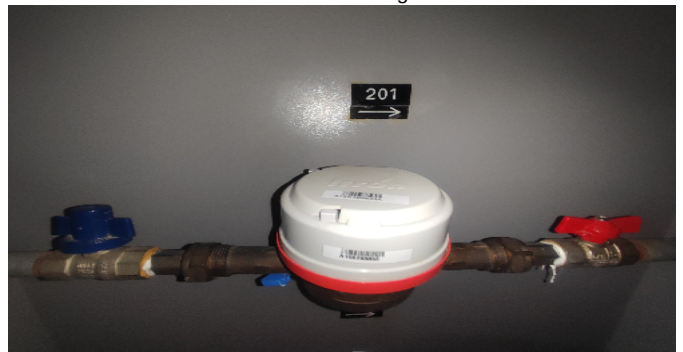
Contador de Agua
