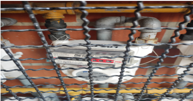
Contador de Gas
