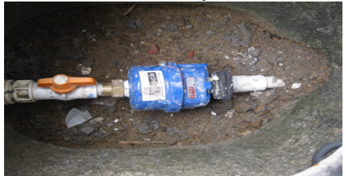
Contador de Agua
