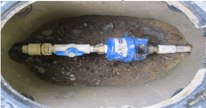
Contador de Agua
