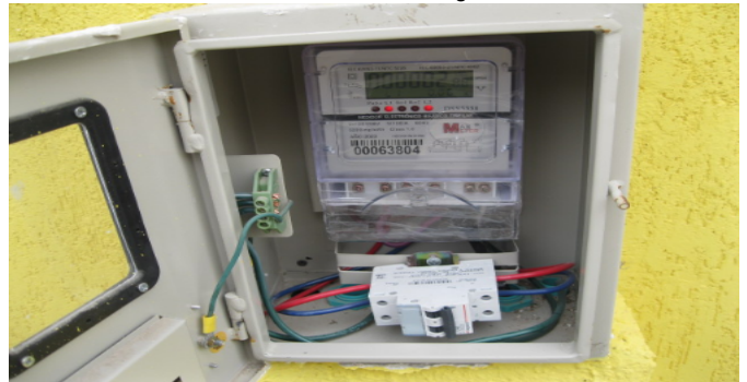
Contador de Energia
