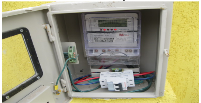
Contador de Energia
