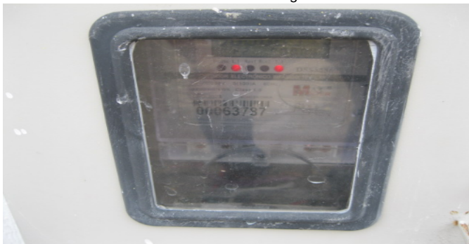
Contador de Energia
