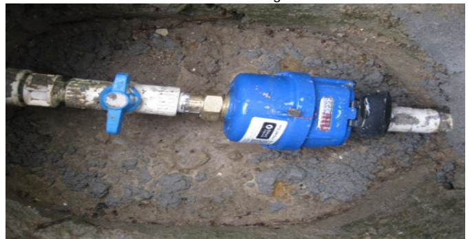
Contador de Agua
