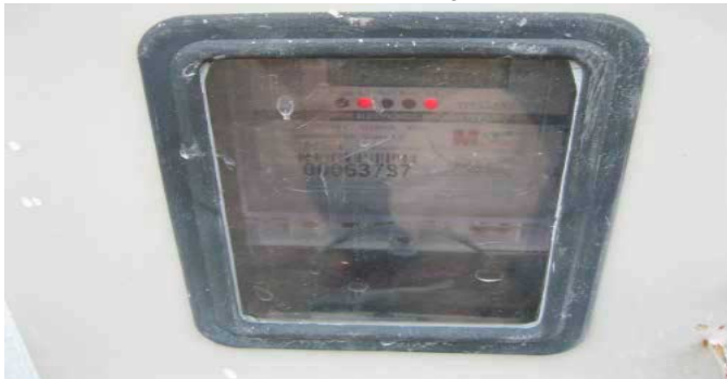
Contador de Energia
