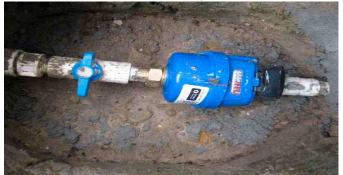
Contador de Agua
