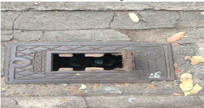
Contador de Agua
