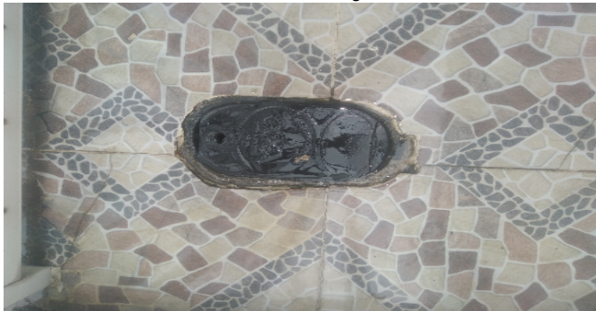
Contador de Agua
