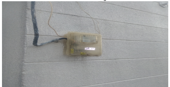
Contador de Energia
