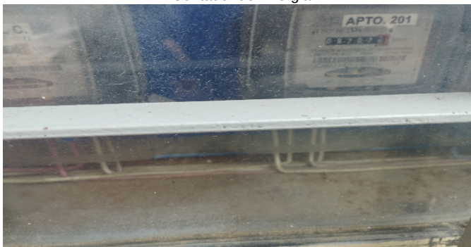
Contador de Energia
