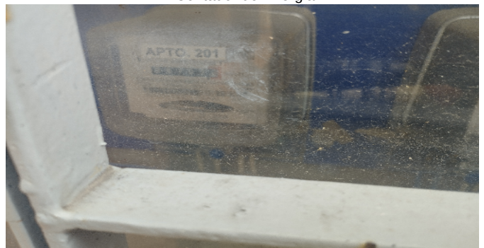
Contador de Energia
