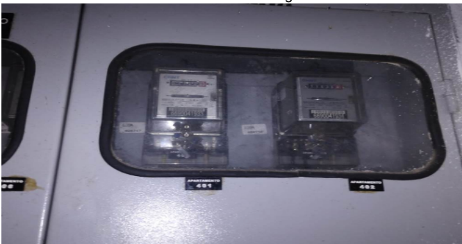
Contador de Energia
