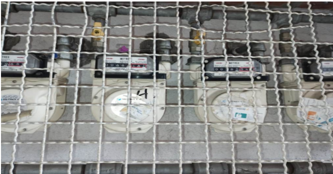
Contador de Gas
