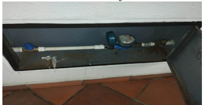
Contador de Agua
