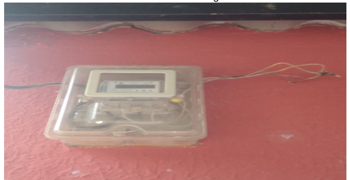
Contador de Energia
