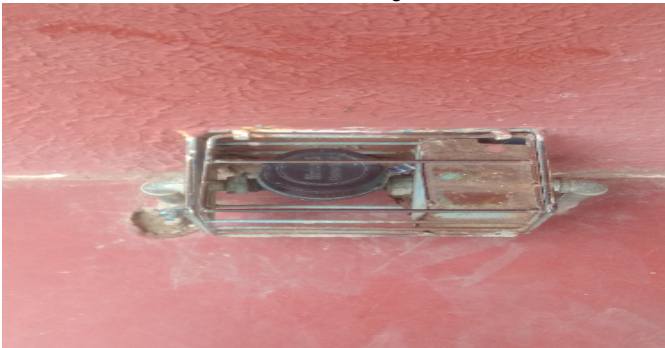
Contador de Agua
