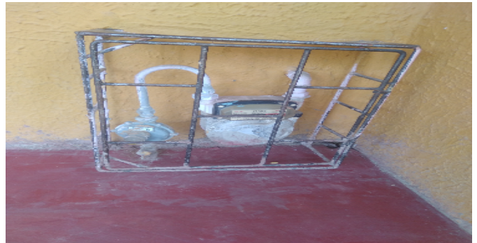
Contador de Gas
