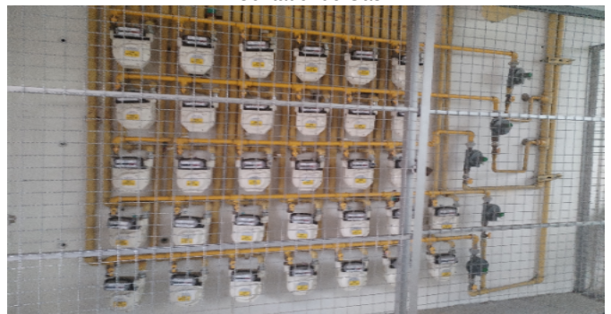
Contador de Gas
