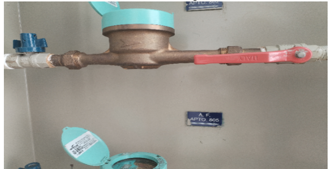
Contador de Agua
