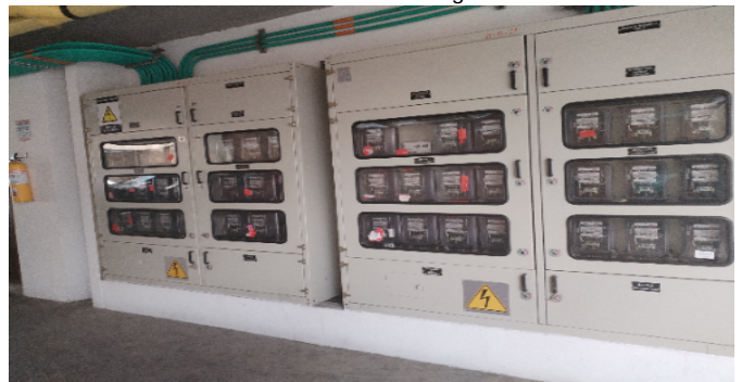
Contador de Energia
