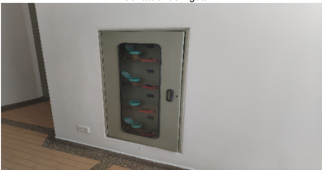
Contador de Agua
