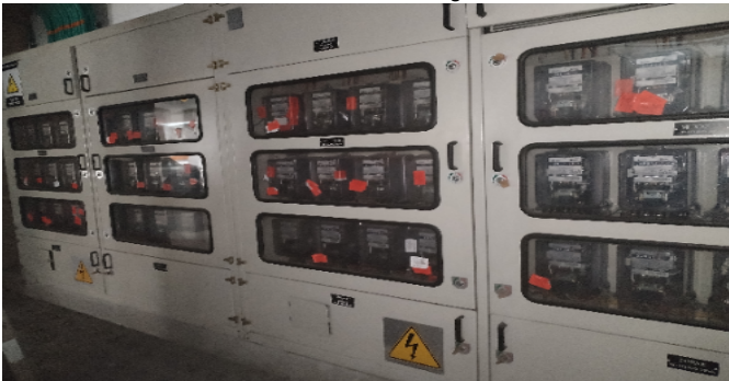
Contador de Energia
