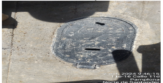
Contador de Agua
