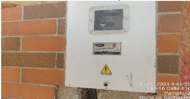
Contador de Energia
