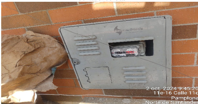
Contador de Gas
