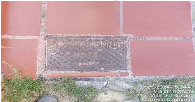
Contador de Agua
