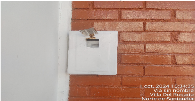
Contador de Energia
