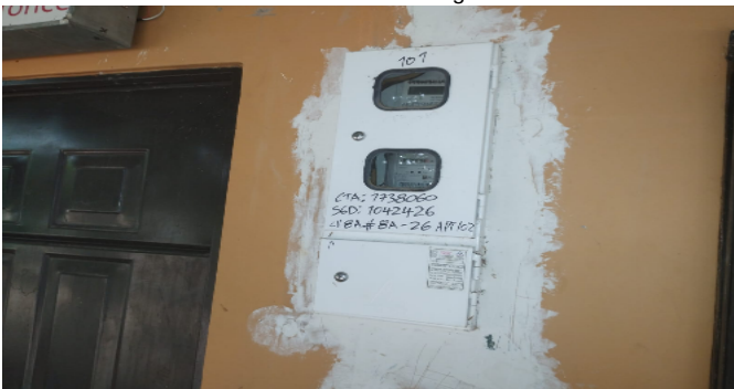
Contador de Energia
