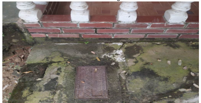
Contador de Agua
