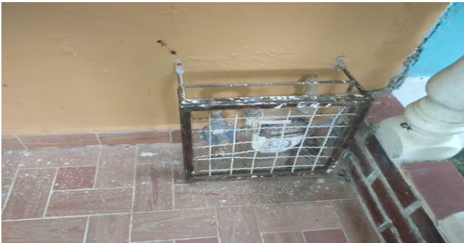
Contador de Gas
