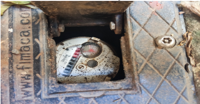
Contador de Agua
