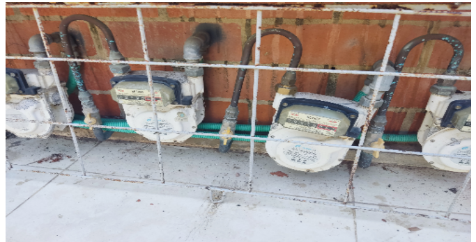
Contador de Gas
