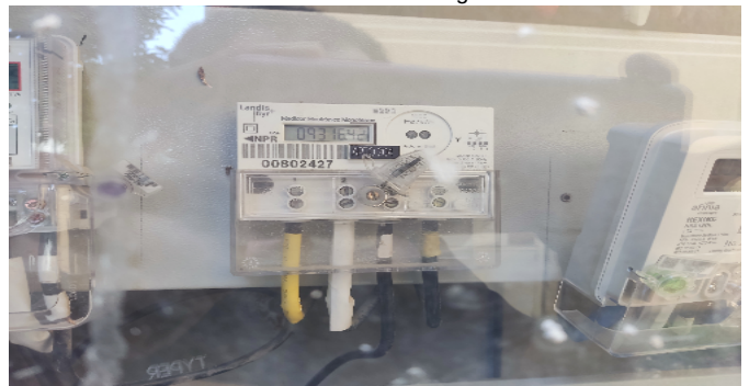
Contador de Energia
