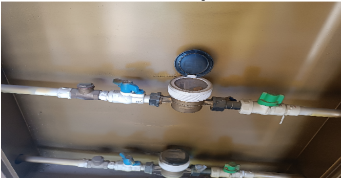
Contador de Agua
