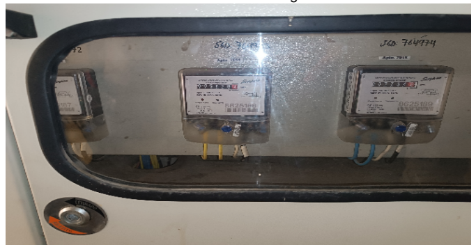
Contador de Energia
