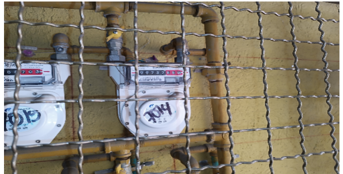
Contador de Gas
