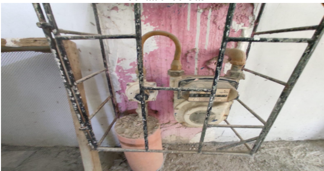
Contador de Gas
