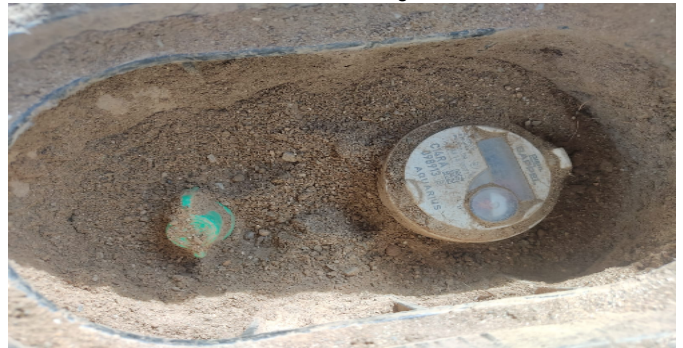
Contador de Agua
