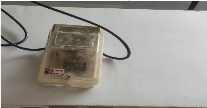
Contador de Energia
