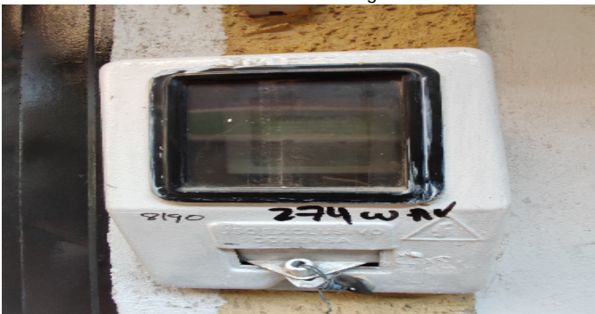
Contador de Energia
