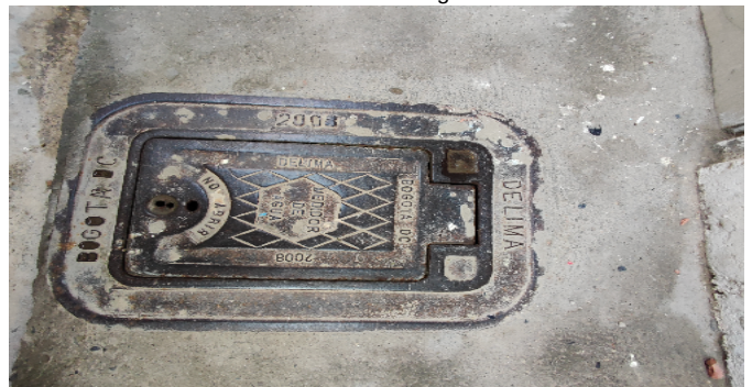
Contador de Agua
