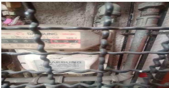
Contador de Gas
