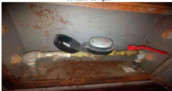
Contador de Agua
