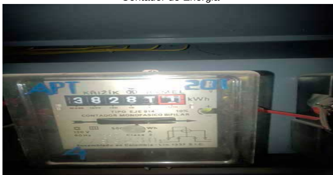
Contador de Energia
