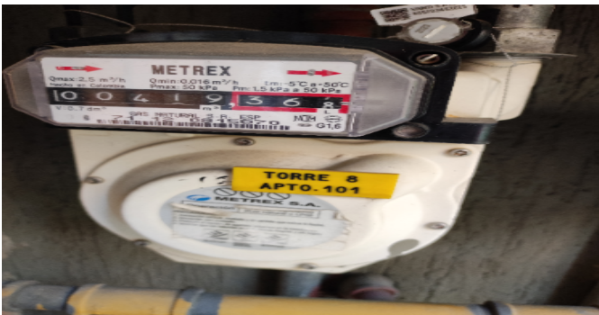
Contador de Gas
