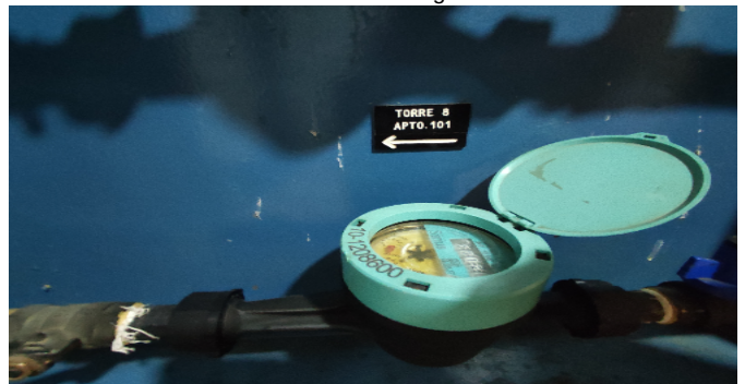
Contador de Agua
