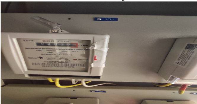
Contador de Energia
