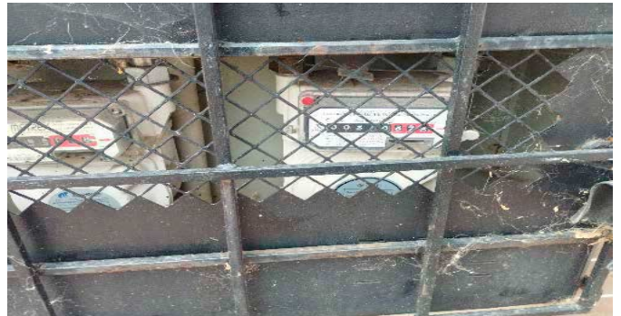
Contador de Gas
