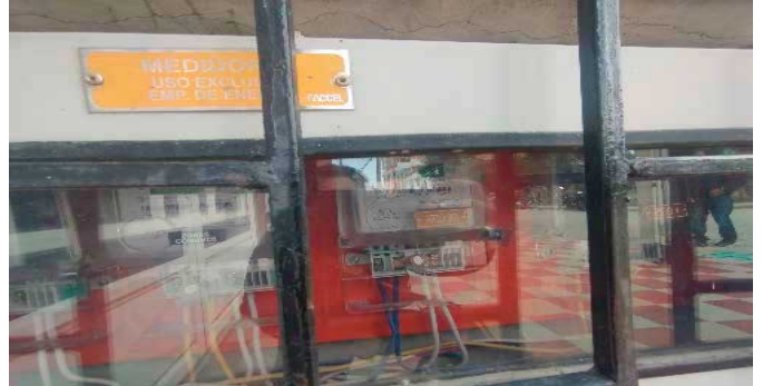
Contador de Energia
