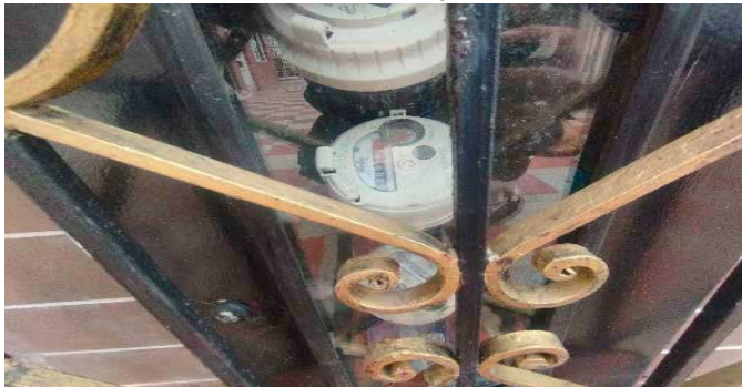
Contador de Agua
