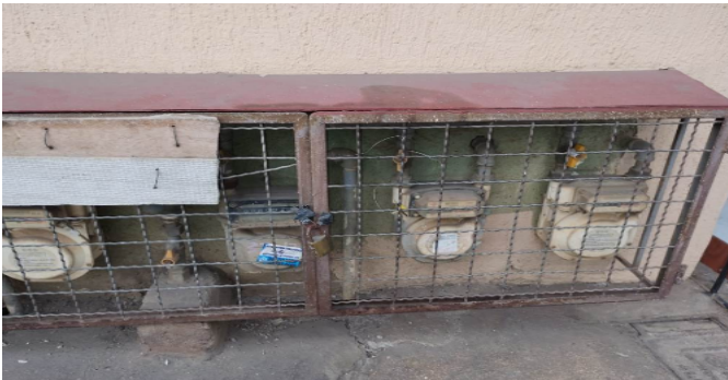
Contador de Gas
