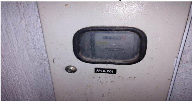
Contador de Energia
