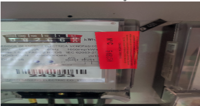
Contador de Energia
