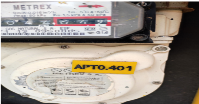
Contador de Gas
