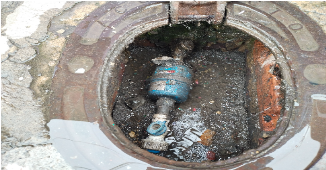
Contador de Agua
