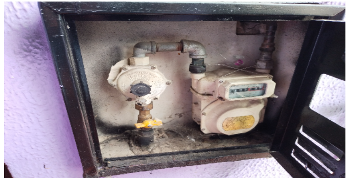
Contador de Gas
