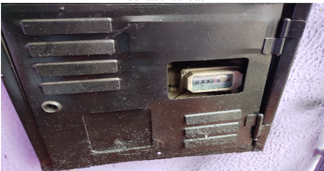
Contador de Gas
