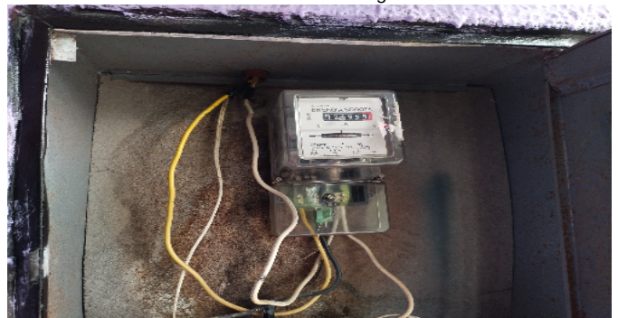
Contador de Energia
