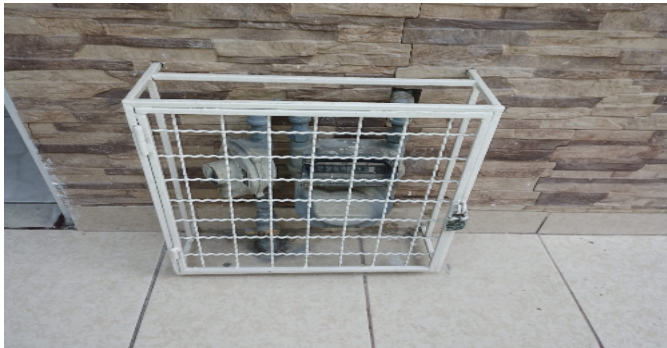
Contador de Gas
