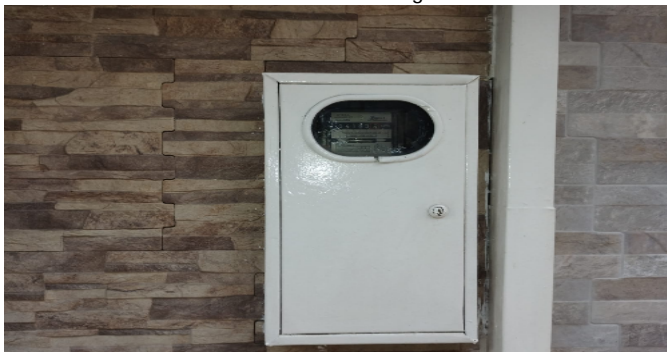
Contador de Energia
