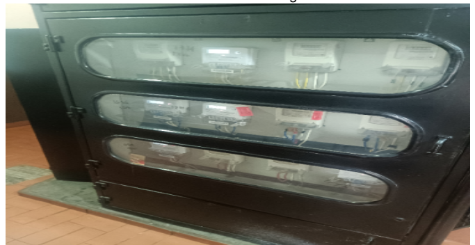
Contador de Energia
