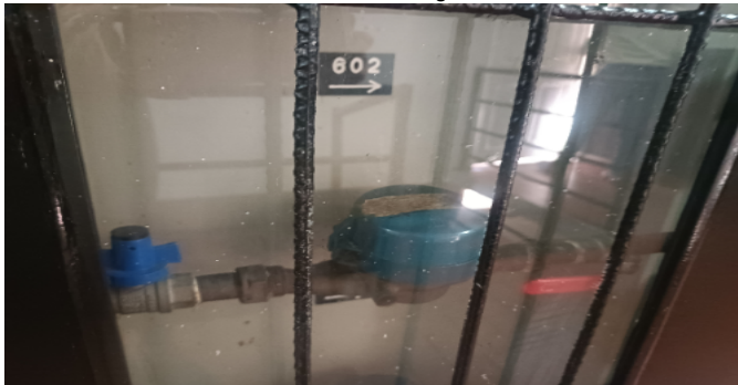
Contador de Agua
