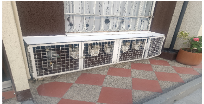
Contador de Gas
